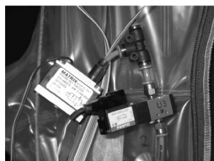
Sl.18 Elektromagnetski ventili za upuh i ispuh komprimiranog zraka u termoizolacijske komore s dijelom zrakovodnog sustava i T-utičnim spojem
